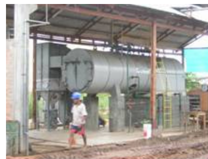
Figura 4: Nuevo caldero alimentado con aserrín
