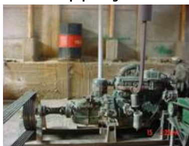
Figura 3: Motor diesel del equipo Meguetti
